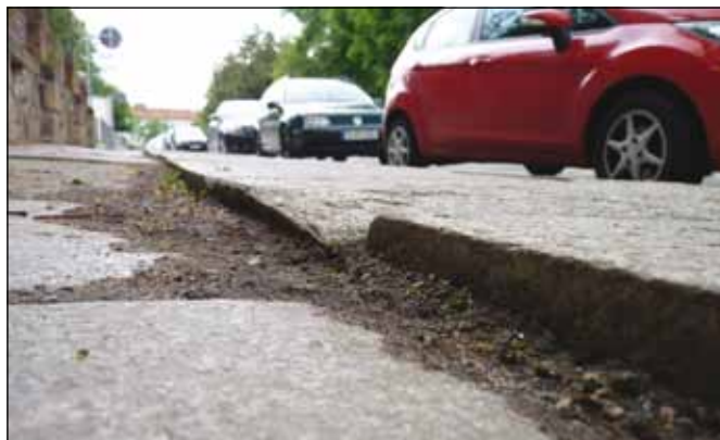
Die Rembrandtstraße ist in einem sehr schlechten Zustand, was vor allem für Behinderte und Senioren ein großes Problem darstellt. Foto: Günther
