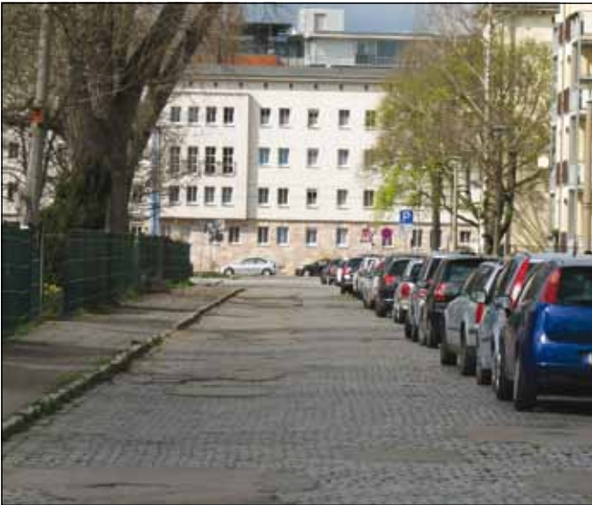
Der Zustand der Brauhausstraße (Foto), der Wiesenstraße und vieler Gehwege ist immer wieder Anlass zur Kritik.
