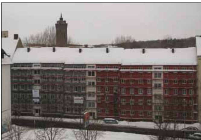
Die GGG hat die Häuser Reichenhainer Straße 6 bis 12 verkauft. Nun werden die Gebäude von einem privaten Investor saniert. Hier entstehen energiekostenoptimierte 2-, 3- und 4-Zimmer-Wohnungen mit Balkons und Parkflächen.
